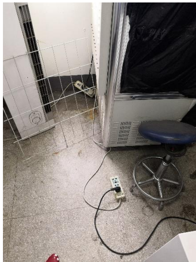
资环楼 A604—接线板串接仪器设备，且直接放置于地面使用
