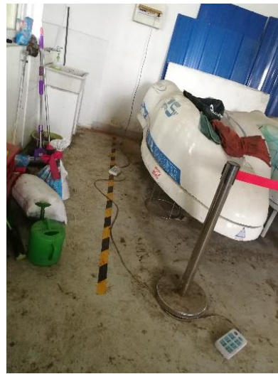
宁远车队—接线板串接使用， 且直接放置于地面
