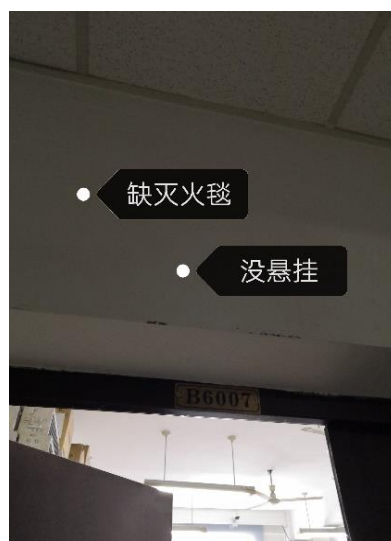
生科楼 B6007—实验室无灭火毯
