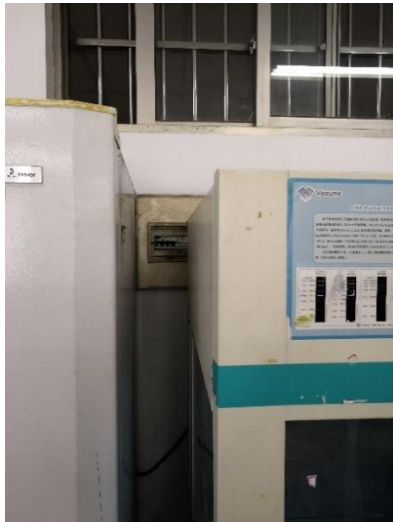
生科楼 B6004—强电箱被遮挡
