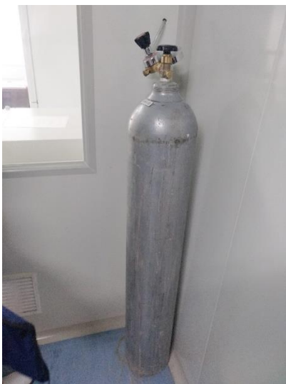
教学楼 B327—气瓶未固定
