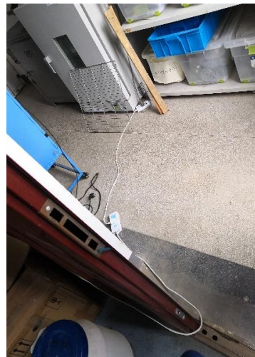
资环楼 A323—接线板串接仪器设备，且直接放置于地面使用
