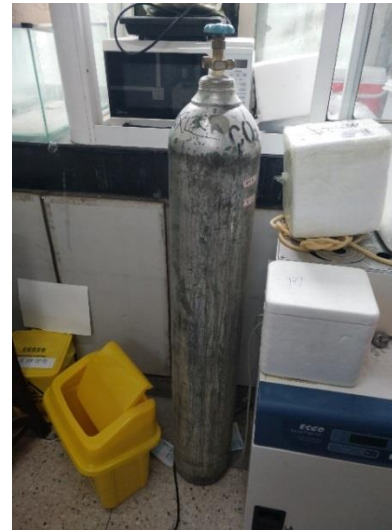
逸夫楼 3066—气瓶未固定
