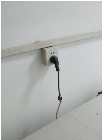
逸夫楼 2 楼 2017 室门口走廊电线裸露
