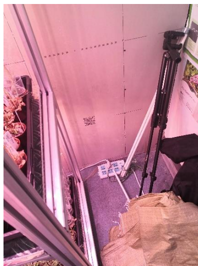
资环楼 A214—无灭火毯， 接线板直接放置于地面使用
