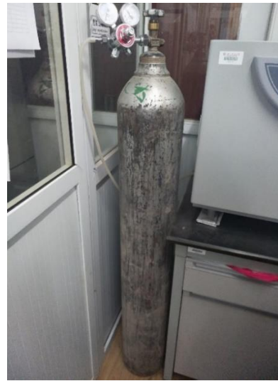
逸夫楼 1033—气瓶未固定
