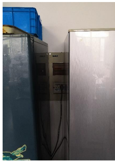
资环楼 A323—强电箱被遮挡
