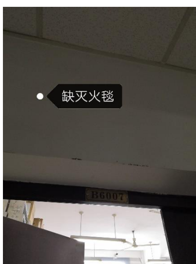
生科楼 B6007—实验室无灭火毯
