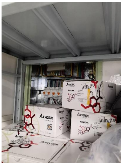
生科楼 B4024—强电箱被遮挡
