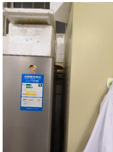
生科楼 B5025—强电箱被遮挡
