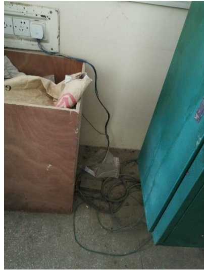
知行楼 101-零线、火线和地线 都裸露，外面无绝缘层
