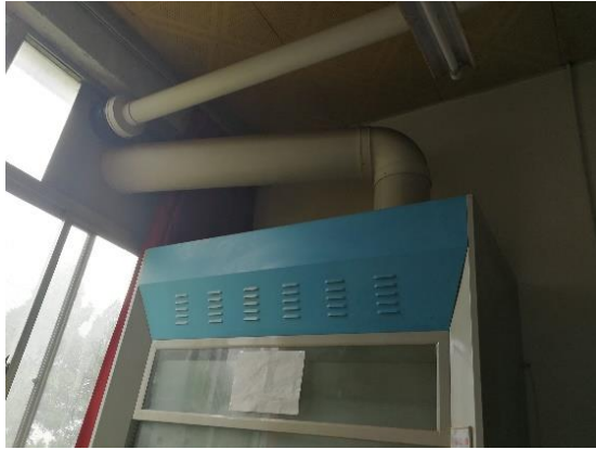
勤学楼 227-通风橱废气未经处理直接排放
