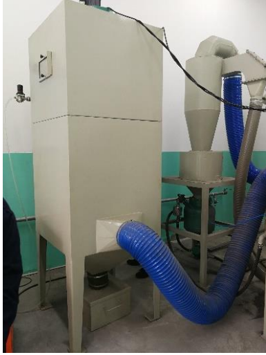
平 15 号楼旁边车库—大型设备未接地
