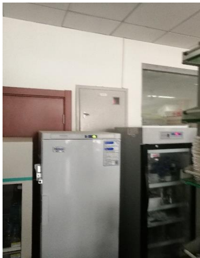
理科南楼 F311—强电箱被遮挡
