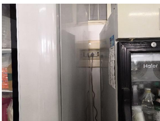
生科楼 7003—强电箱被遮挡
