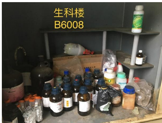
生科楼 B6008—通风橱中堆放大量化学试剂
