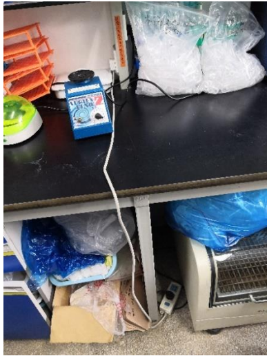
资环楼 A503—接线板直接放置于地面使用
