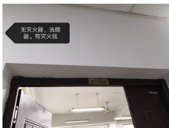
生科楼 B7006—实验室无灭火器、洗眼器
