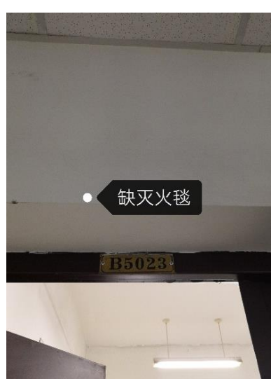
生科楼 B5023—实验室无灭火毯
