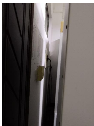
生科楼 A6010—强电箱被遮挡
