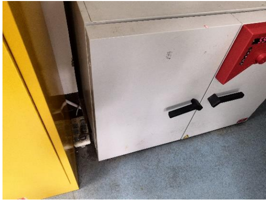
资环楼 A222—接线板直接放置于地面使用
