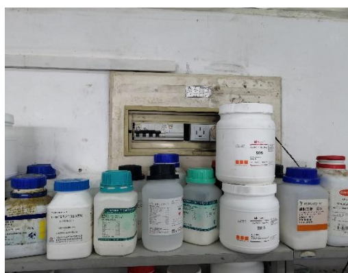
生科楼 7003—强电箱被遮挡
