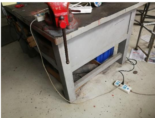
宁远车队—接线板串接使用，且直接放置于地面
