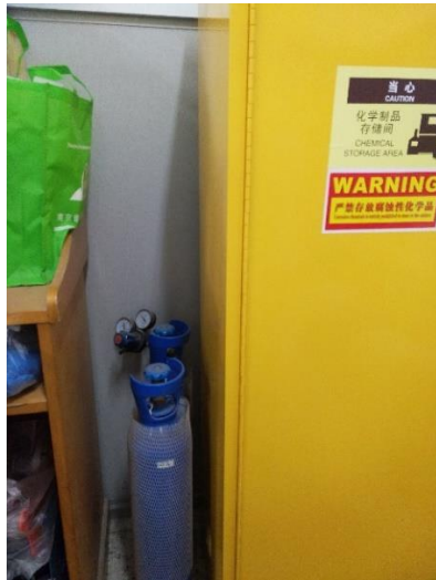
逸夫楼 3068—氧气瓶放在危化品柜旁边且未固定
