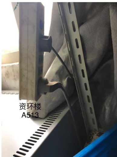
资环楼 A513—接线板悬空
