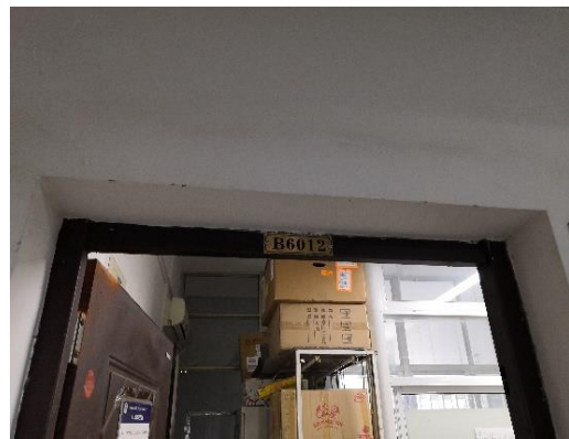
生科楼 B6012—实验室无灭火毯
